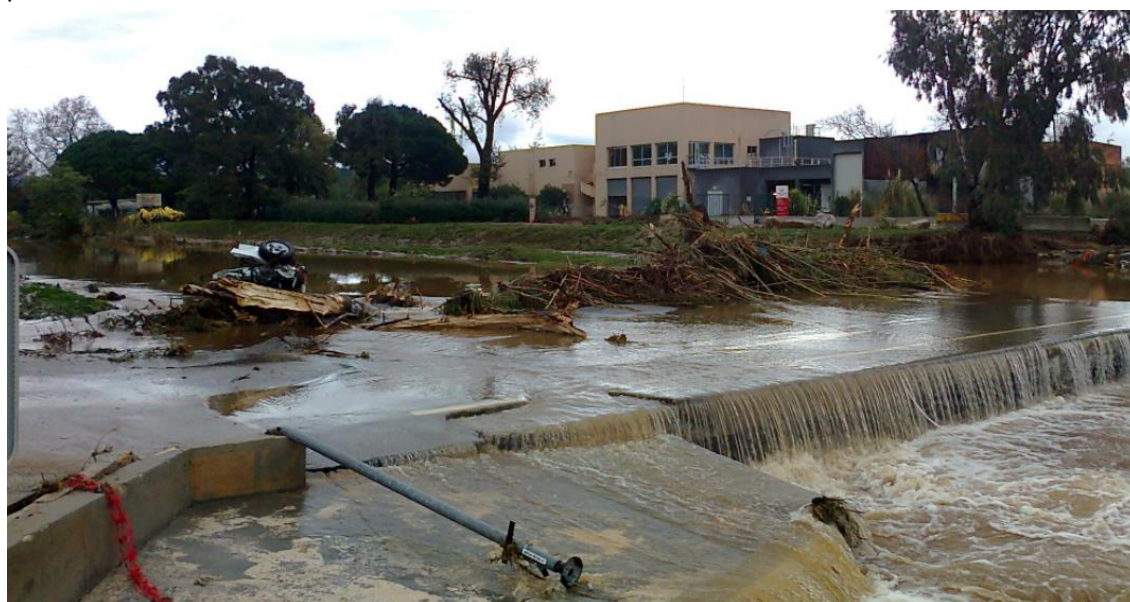
Photo 2 Pont cadre submersible d'accès au port après la crue de janvier 2014
